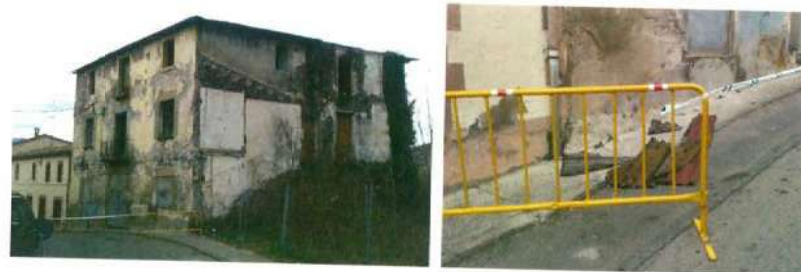
LA COBERTA ( despreniments ) 27-01-2015
